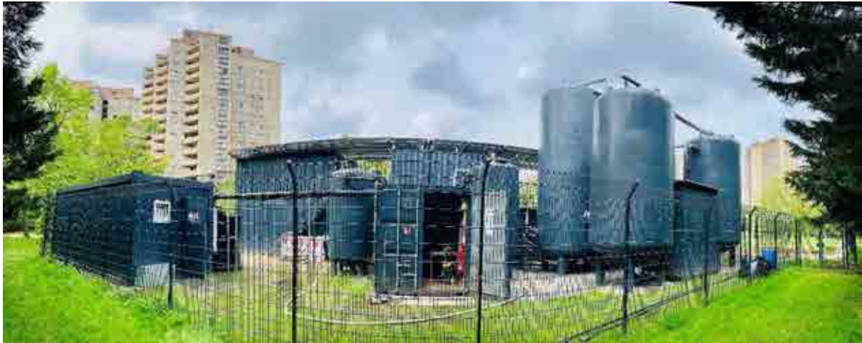
Abb. 2: Grundwasserreinigungsanlage (Quelle: SenMVKU, 2025)
