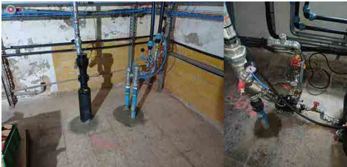
Abbildung 7: Ausgebaute Air-Sparging- und MPE-Brunnen in Bestandsgebäuden, mit Rohrleitungen.
