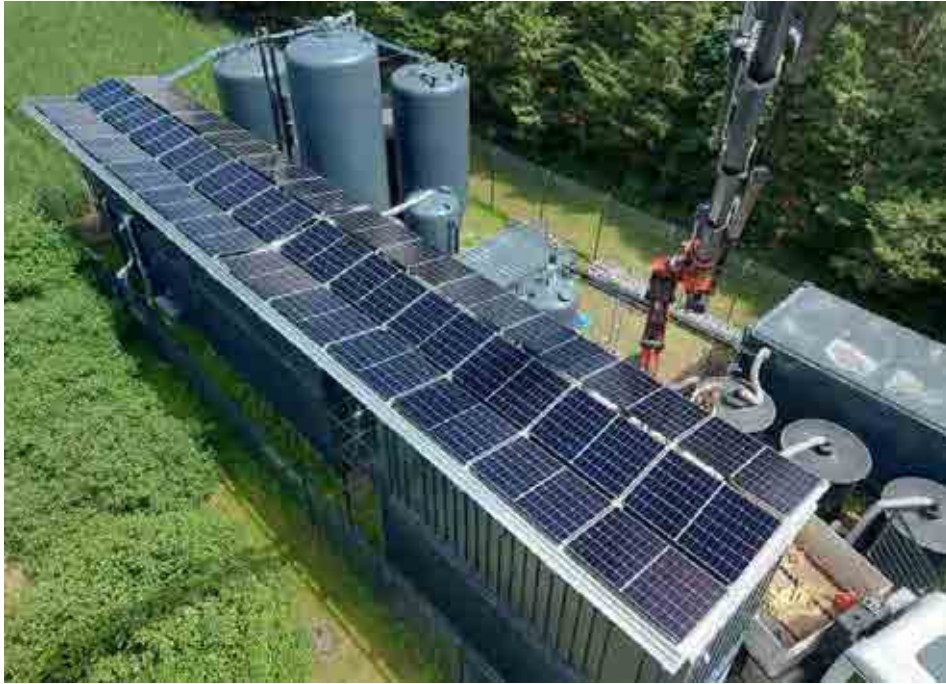
Abb. 5: Photovoltaikanlage auf dem Dach der GWRA (Quelle: Stutz, 2024)
