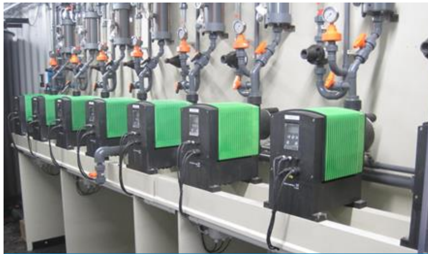
Dosierpumpen für Infiltrationsbrunnen
