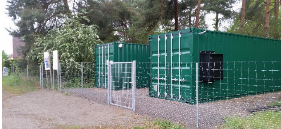
Container für Ansetz- und Dosieranlage
