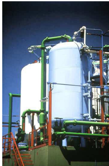
Abb. 24: Ionenaustauscheranlage (ROHM AND HAAS 2008.- In: Ionenaustausch für Laien; www.wallner-wasser.at )
