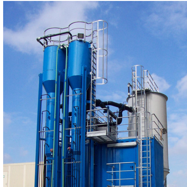
Foto: St. Neumann / © eneotech Umwelt GmbH
